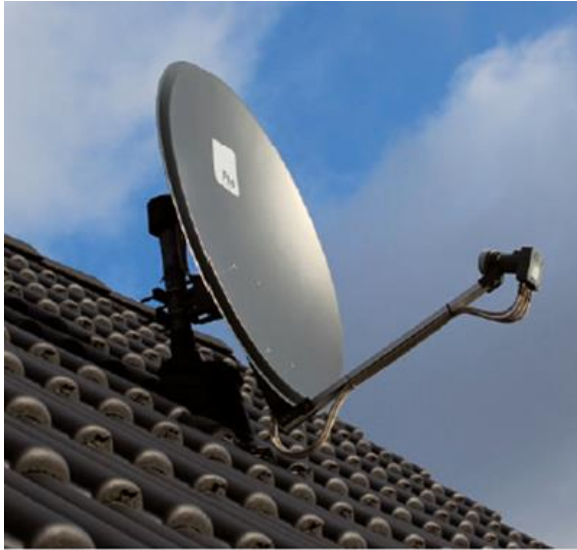
Anschluss einer digitalen Satelliten-Empfangsanlage.
