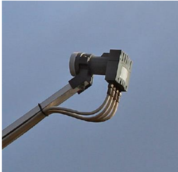
Hier werden 4 Koaxial-Leitungen für den Empfang angeschlossen.
